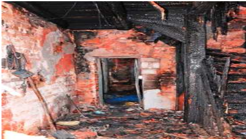
Fot. 8. Miejsce pożaru stodoły
